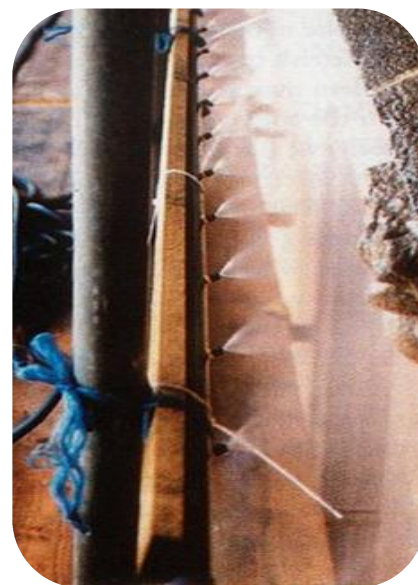
Vandspraying af facade sker gennem påmonterede rør med dyser. Gothergade/Rømersgade, København.
